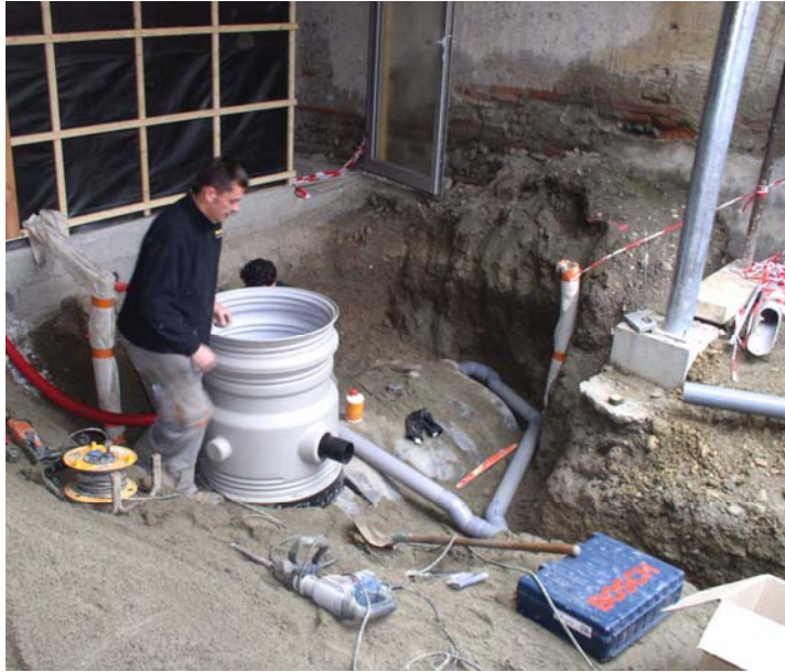
Chantier de reconversion d'un ancien garage toulousain : Création d'un système de récupération des eaux de pluie pour l'alimentation de la chasse d'eau et de la machine à laver.
